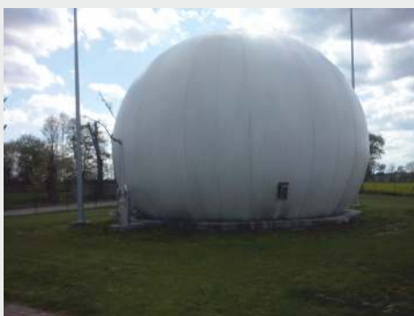
Zbiornik biogazu w Drzycimiu 570 m 3 pojemności
