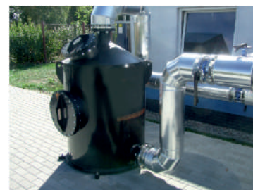
Filtr siloksanów w Zduńskiej Woli 200 Nm^3/h
