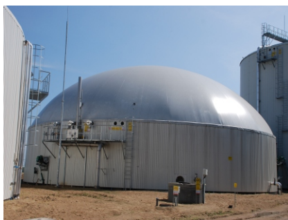
Zbiornik 2-membranowy dach 2200 m 3 Biogazownia Szepietowo
