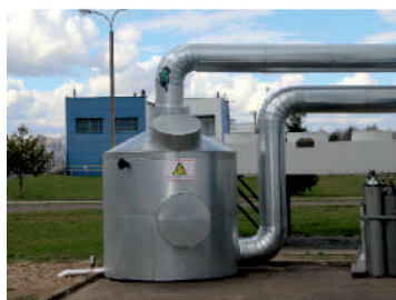
Filtr siloksanów w Łodzi 1300 Nm^3/h
