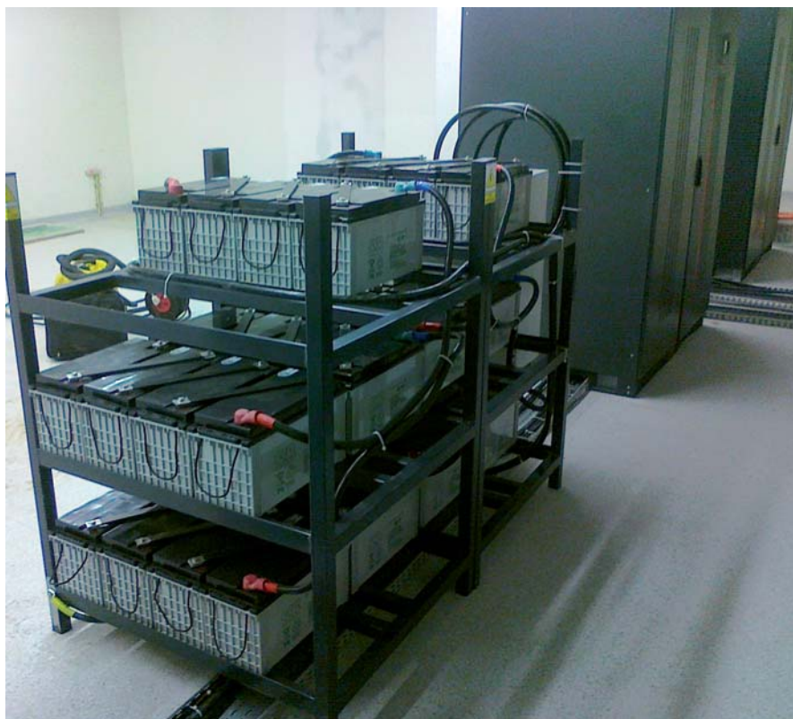
Rys. 3. System zasilania rezerwowego zrealizowany w oparciu o dwa UPS-y Master HP (2 x 300 kVA) w Miasteczku Multimedialnym w Nowym Sączu
