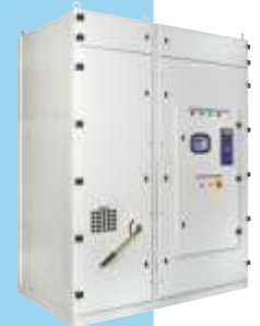
Soft-start 6000V / 250A z szafą przyłączeniową zawierającą odłącznik, bezpieczniki oraz stycznik sieciowy
